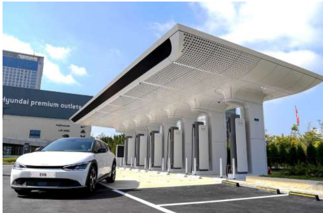
현대프리미엄아울렛 송도점 전기차 충전소
